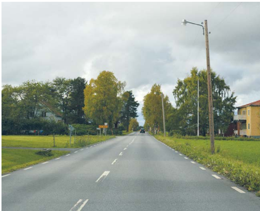
Äldre belysningsanläggning längs statlig väg. Foto: Henrik Gidlund
